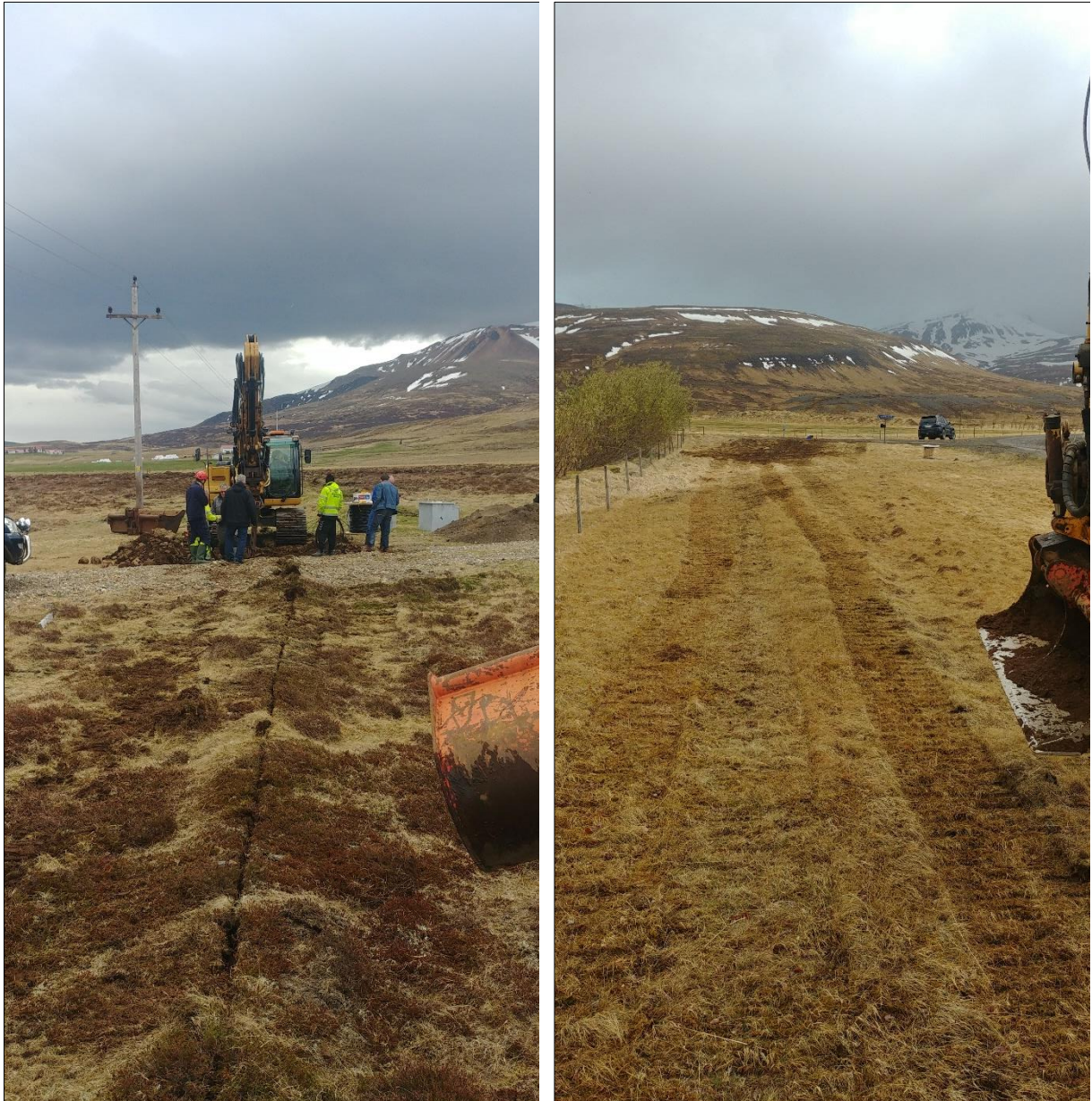
Mynd 3.7 Myndir sem sýna ummerki eftir lagningu 11 kV strengs. Á myndinni til vinstri hefur strengur verið plægður niður en frágangur er eftir. Myndin til hægri sýnir ummerki að frágangi loknum.
